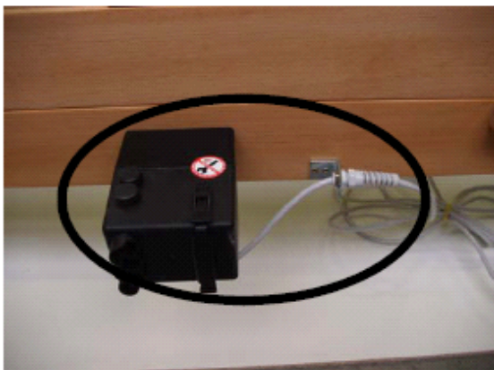
Fig. 4: Strekkavlastning og styreapparat montert på montasjeplate
